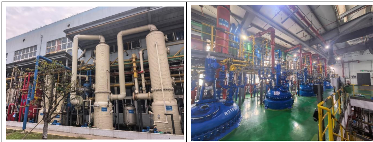
图 4.1-4 三车间废气预处理和无组织收集设施
