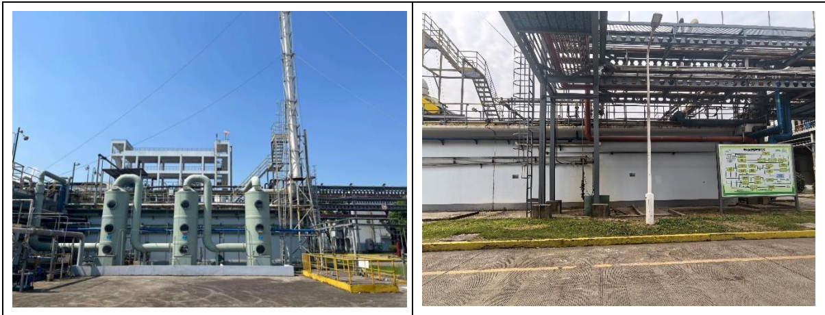
图 4.1-6 污水处理站废气处理设施
