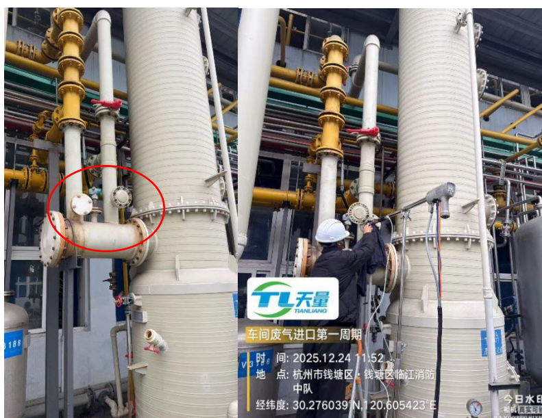
图 9.2-1 三车间废气预处理设施进口
