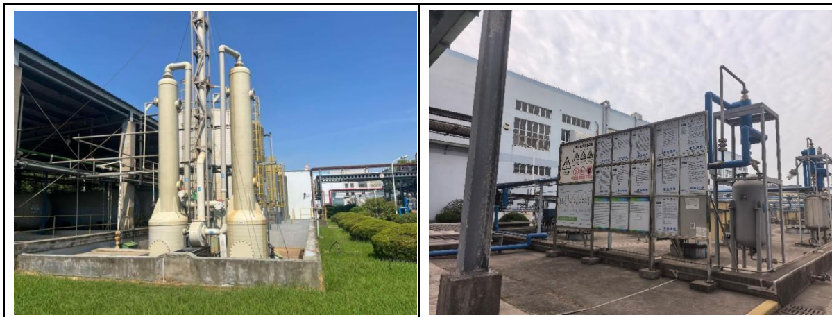
图 4.1-5 罐区废气处理设施
